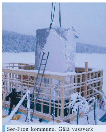
Sør-Fron kommune, Gålå vassverk
