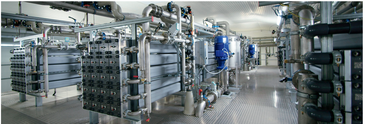
Niederdruck-Umkehrosmoseanlage (LPRO) zur Enthärtung und PFC-Entfernung
