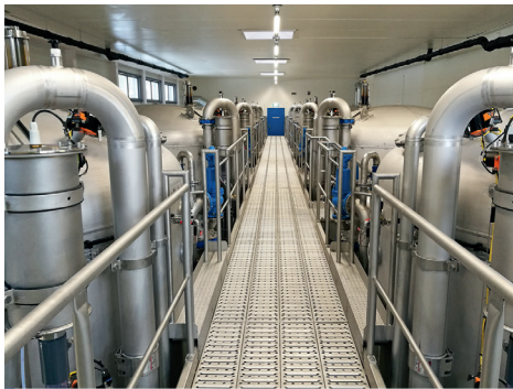
Filteranlagen zur Entmanganung
